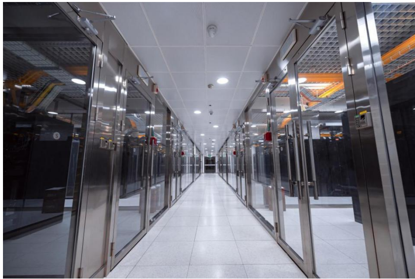
湖州银行湖东数据中心信息系统
