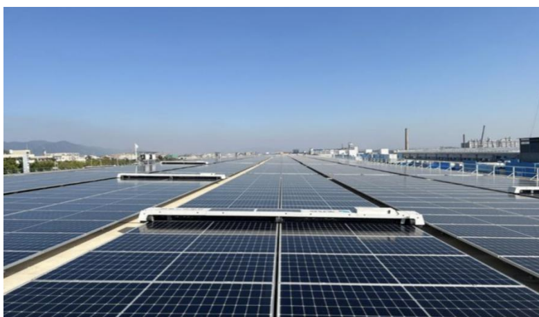
腾讯仪征东升云计算数据中心1号楼分布式光伏系统
